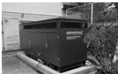
大型の自家発電機
